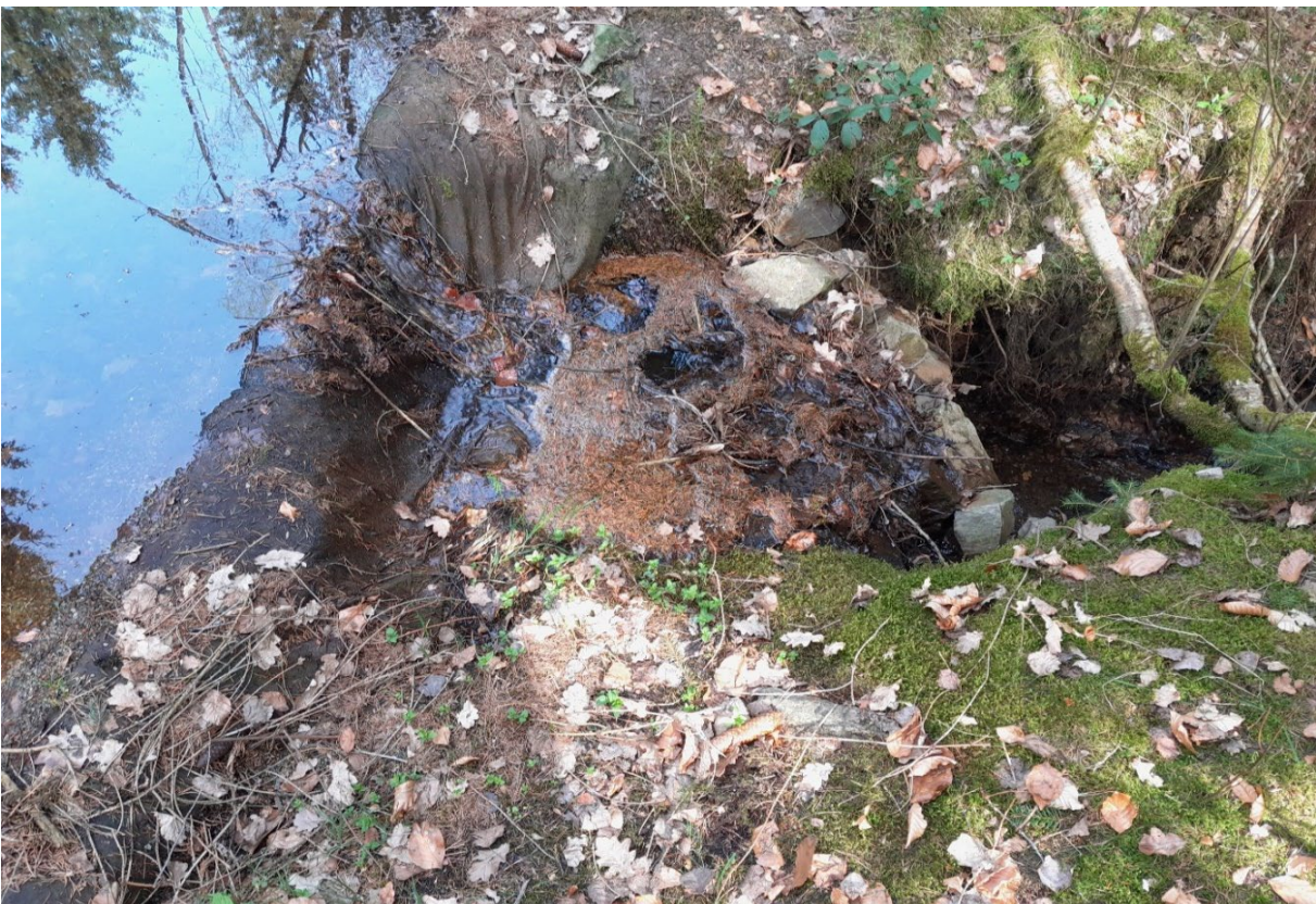
Abbildung 34: Provisorisch reparierter Überlauf des „Froschteiches“
