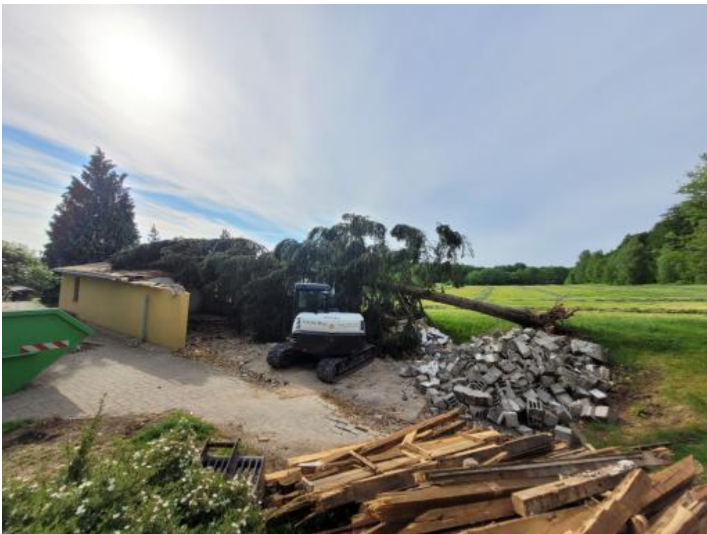
Schaden auf der Baustelle durch den Gewittersturm am 20.5., Foto: Marie Ahnert
