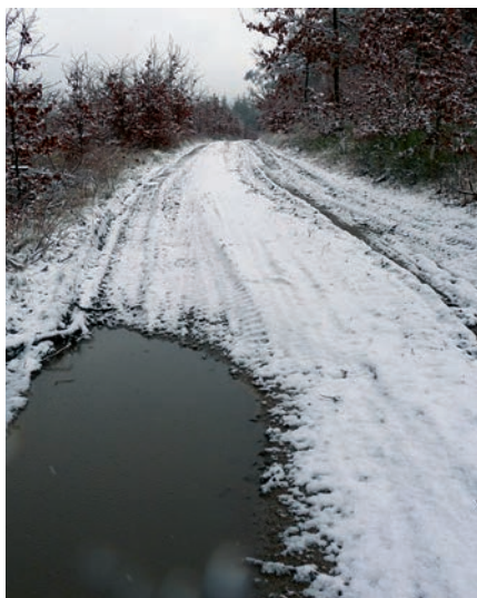
Holzabfuhrweg mit schweren Schäden
